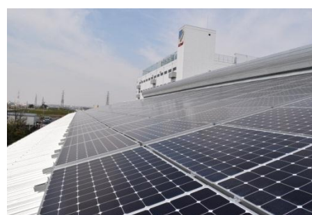
関西不二サッシ 太陽光発電所
