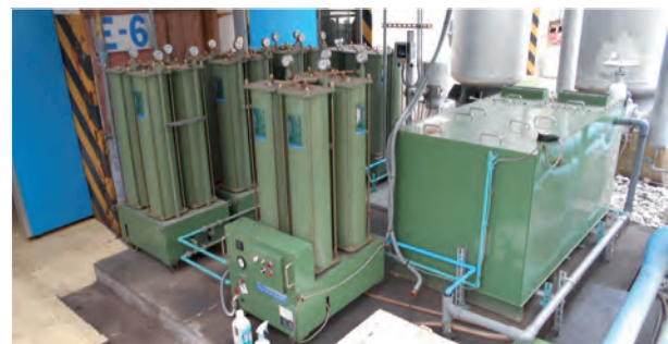
ドレン処理装置
