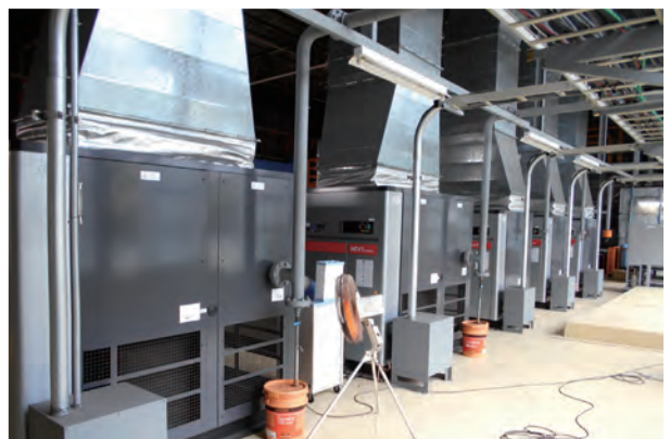
コンプレッサー全景
