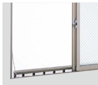
(面格子が完全にはずれた状態)
