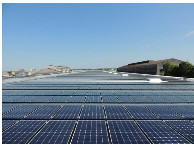
千葉事業所 第2発電所
