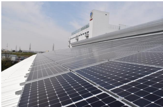
関西不二サッシ 太陽光発電所
