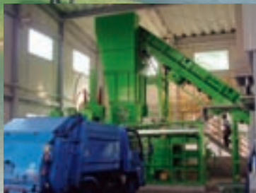
リサイクル設備
