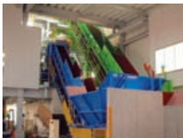
リサイクル設備
